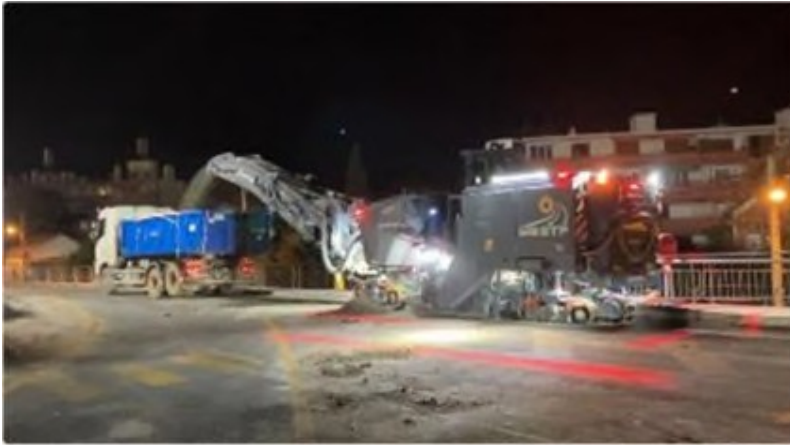
Rabotage sous brumisation de la chaussée par bandes. Le fraïsat tombe directement dans le conteneur bag placée dans la benne.
